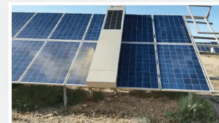
应用项目 甘肃 100MW 地面电站
