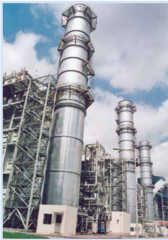
华能石洞口燃机电厂
