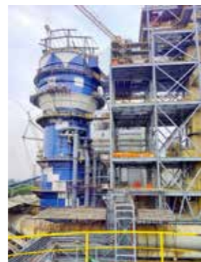
宝钢2×350MW超净排放改造
